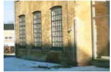
4 Jahre später. Die Mauern sind trocken.
