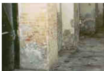
Vor der Entfernung des alten Putzes. Feuchteschäden und alte Reparaturen sind sichtbar.
