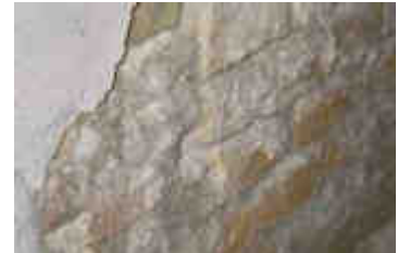
10 - 12 mm lange Salzausblühungen im Gebäudeteil, der vom Wasser am weitesten entfernt liegt.
